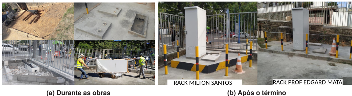
Figura 2. Implantação dos racks outdoor
